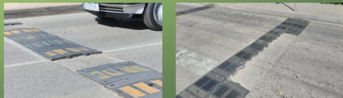
Oštećeni gumeni elementi
